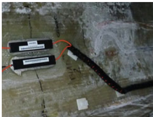
Fig. 2.10 Câble protégé par des tuyaux ondulés
