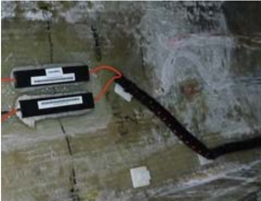
Abb. 3.12 Mit Wellrohren geschütztes Kabel
