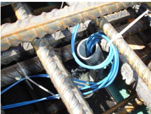
Abb. 2.2 Detailansicht der Kabelführung
