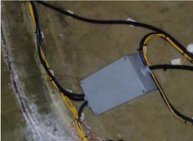
Abb. 2.31 Schutzgehäuse für nicht benötigte Kabel und Anschlüsse
