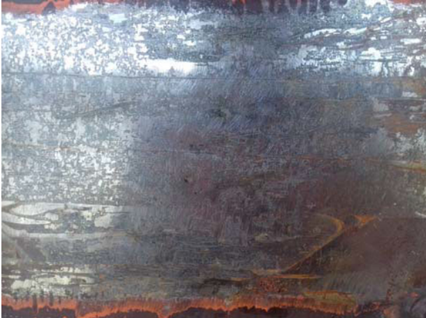
Abb. 2.2 Unebene und rostige Oberfläche, ungeeignet für den anschweißbaren Sensor
