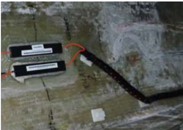
Abb. 2.30 Mit Wellrohren geschütztes Kabel
