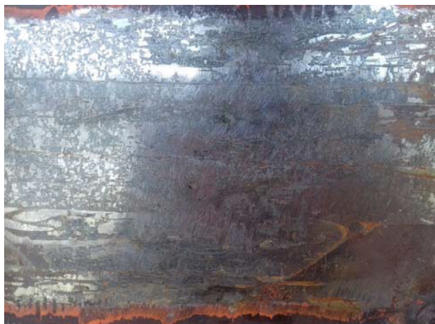
Fig. 2.2 Surface non plane et rouillée ne permettant pas le soudage du capteur
