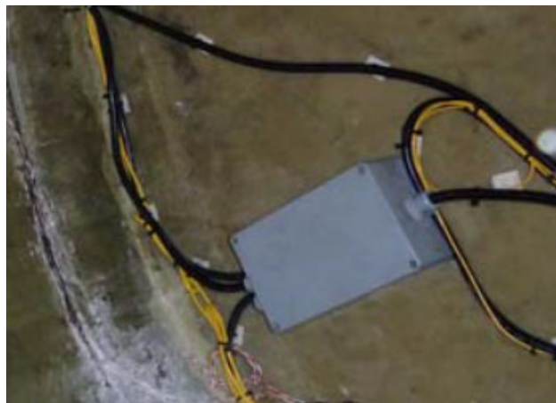
図2.31 ケーブル配線で余った長さ部分と接続端子を保護する端子箱
