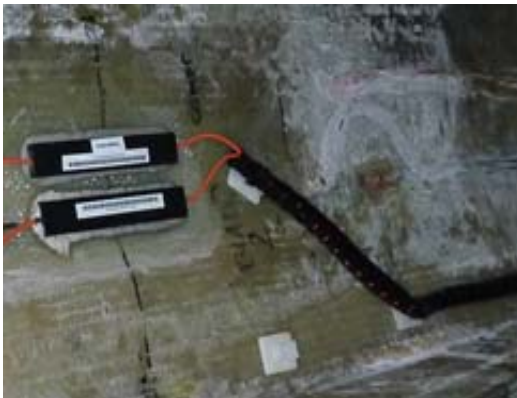
Abb. 2.3 Mit Wellrohren geschütztes Kabel
