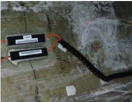
Fig. 2.3 Câble protégé par des tuyaux ondulés
