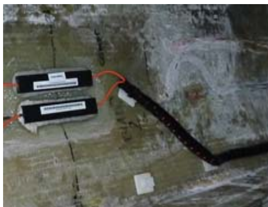
図. 2.14 コルゲートチューブにより保護したケーブル
