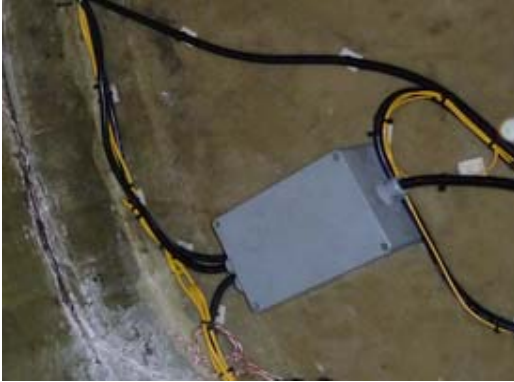
図. 2.15 ケーブルで余った長さの部分と端子を保護する端子箱
