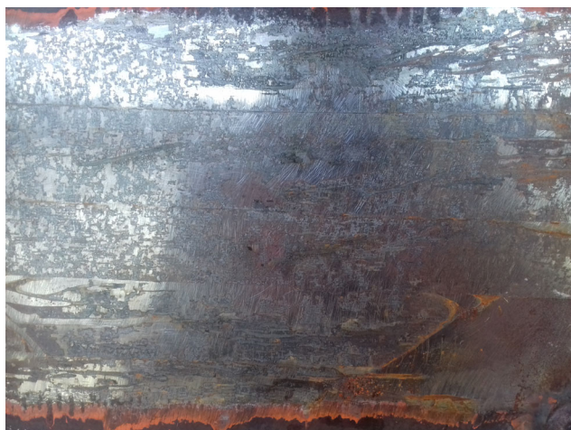
Fig. 2.2 Surface non plane et rouillée ne permettant pas le soudage du capteur
