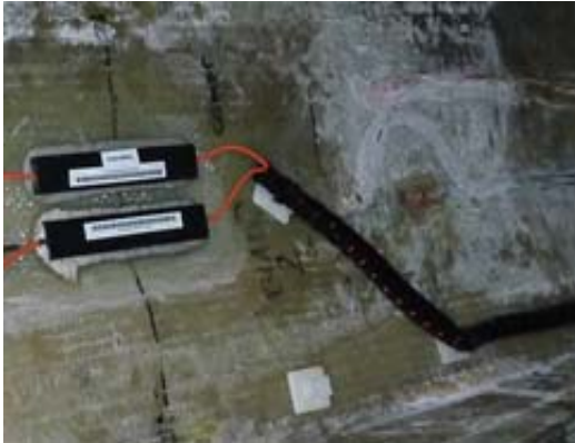
Fig. 2.8 Câble protégé par des tuyaux ondulés
