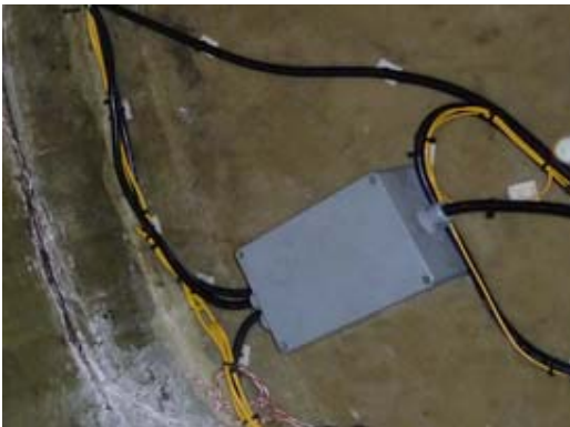
図. 2.9 ケーブルで余った長さの部分と端子を保護する端子箱
