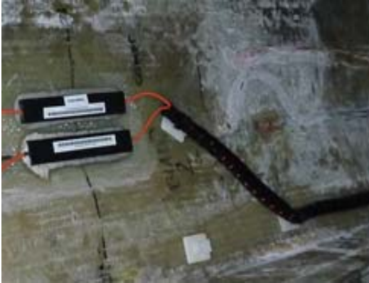
図. 2.8 コルゲートチューブにより保護したケーブル
