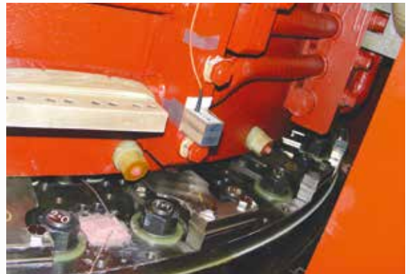
Installation von optischen Schwingungssensoren an einem Leistungsgenerator
