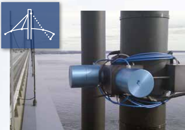
Schwingungsüberwachung mit optischen Sensoren an der Brücke über den Großen Belt in Dänemark
