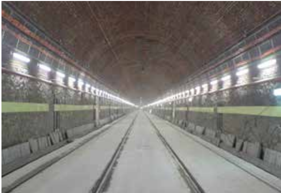
Mit Messtechnik bestückte Abschnitte des Tunnels
