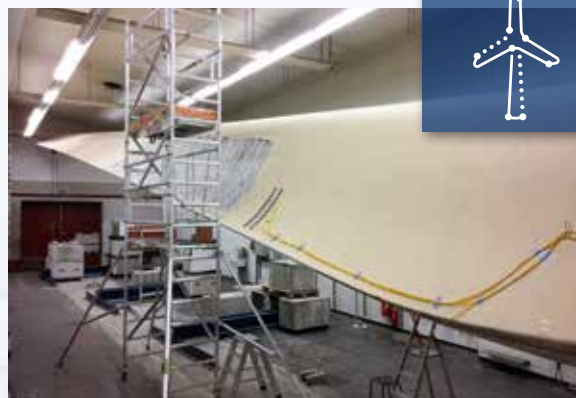
風力発電用の風車ブレードに 光ファイバ式ひずみセンサを設置
