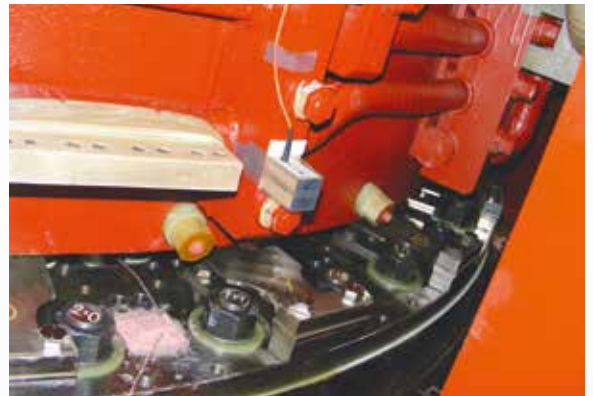
光ファイバ式振動センサを発電機に設置
