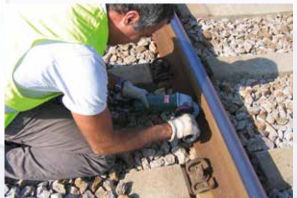
鉄道レールに光ファイバ式ひずみセンサを設置
