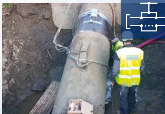
水力発電の導水路用パイプのモニタリングに 光ファイバ式センサを設置
