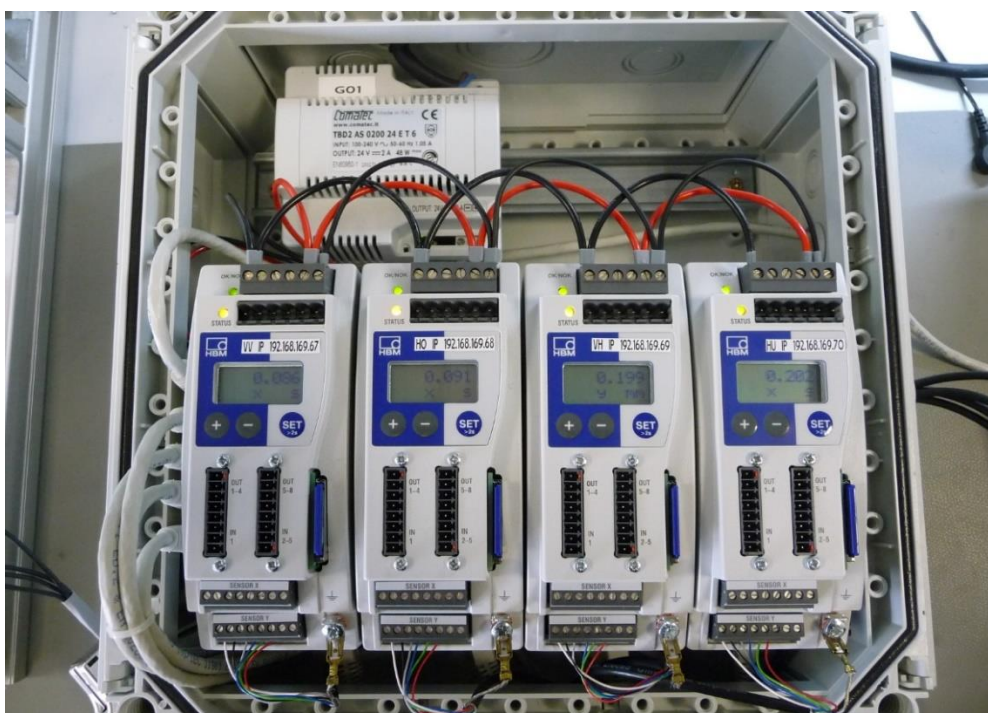
Abb. 1 MP85A Prozesskontroller im Schaltschrank
