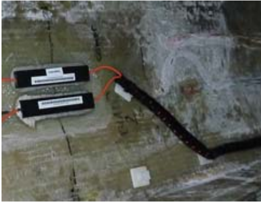
Fig. 3.12 Câble protégé par des tuyaux ondulés
