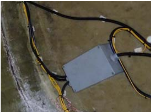
図. 3.13 ケーブル配線で余った長さ部分と接続端子を保護する端子箱
