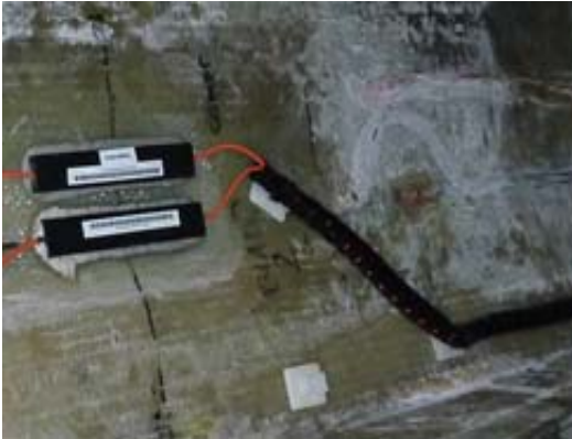
図. 3.12 コルゲートチューブにより保護されたケーブル
