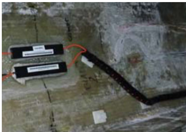
Fig. 2.36 Câble protégé par des tuyaux ondulés
