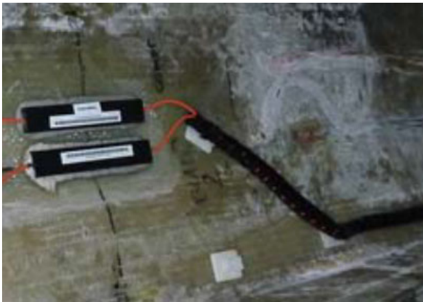
図2.36 コルゲートチューブにより保護されたケーブル
