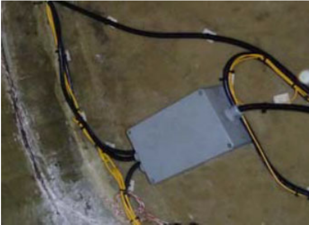
図2.37 ケーブル配線で余った長さ部分と接続端子を保護する端子箱
