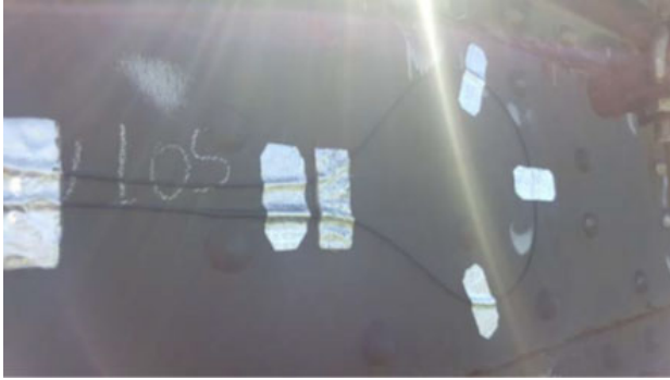
図2.35 ケーブル配線
