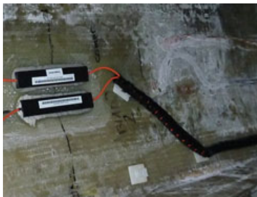
図2.15 コルゲートチューブにより保護されたケーブル
