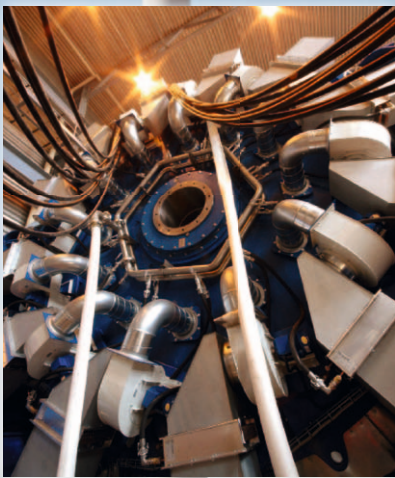
The Switch社製の永久磁石発電機
