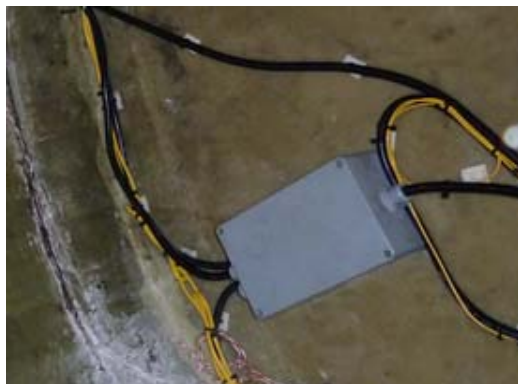
図. 2.4 ケーブルで余った長さの部分と端子を保護する端子箱
