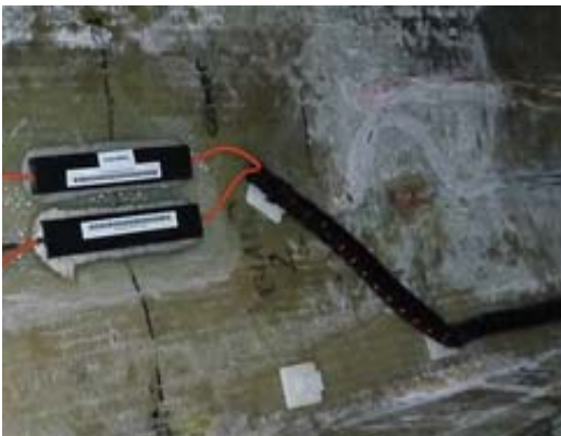
図. 2.3 コルゲートチューブにより保護したケーブル
